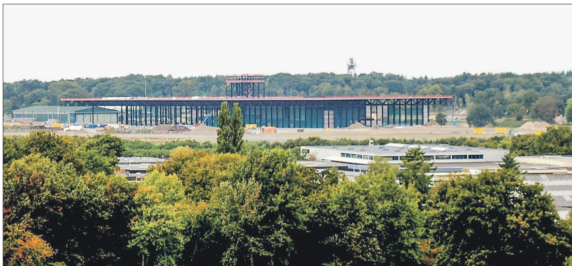
● Toen het museum nog in aanbouw was. Duidelijk is een deel van de staalconstructie te zien die het museum de Nationale Staalprijs opleverde.
