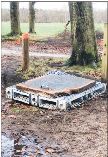
● Onder de deksel is na het ongeval door de gemeente een plastic pallet over de put gelegd.
