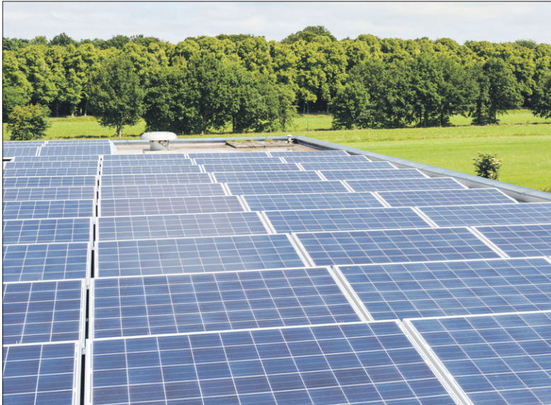
● Een deel van de 695 zonnepanelen op het dak van de school.
