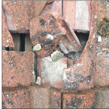
● Schade aan dak: € ??.
