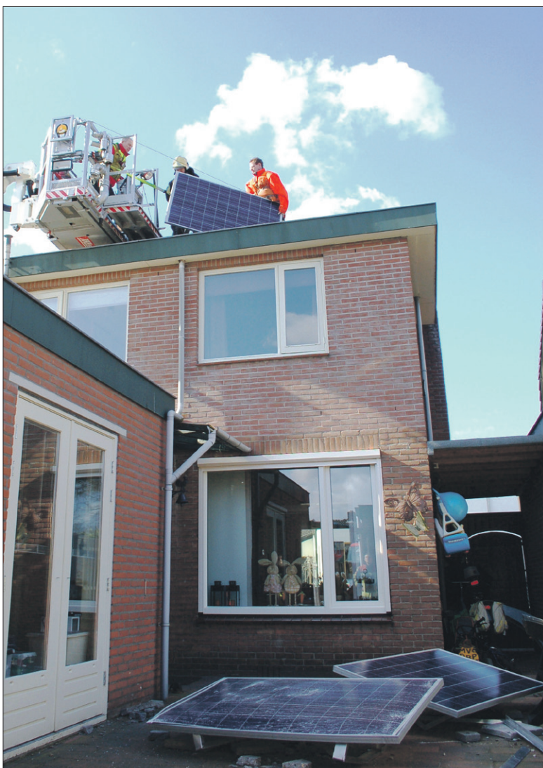
● De brandweer haalt een zonnepaneel van het dak van een woning aan de Nieuwstraat. Twee andere panelen zijn eerder op de binnenplaats gevallen, nadat de storm ze had losgerukt.
