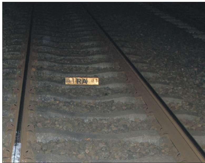
• Een achtergebleven steen op het baanvak. Er lag een partij stenen op, waarvan niet uitgesloten is dat ze er moedwillig is neergelegd. Foto: Eempers
