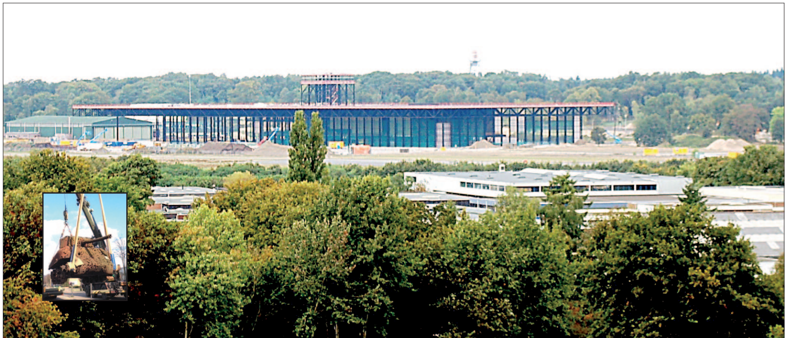
● De omvang van het Nationaal Militair Museum is in deze fase van de bouw al goed waar te nemen. Inzetje: de Sherman tank.
