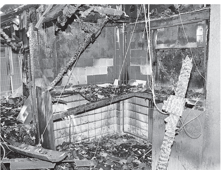
• Letterlijk een kijkje in de keukens van het gebouw op het voormalige ijsbaanterrein. Het is duidelijk dat de brand onherstelbare schade heeft aangericht. Foto: Eempers.
