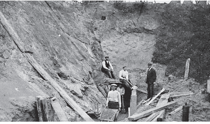
● Overzicht van het graven van nieuwe kanalen (1934) bij Soestduinen voor de Utrechtse Waterleiding Maatschappij. (Bron: Eemland Pers).
