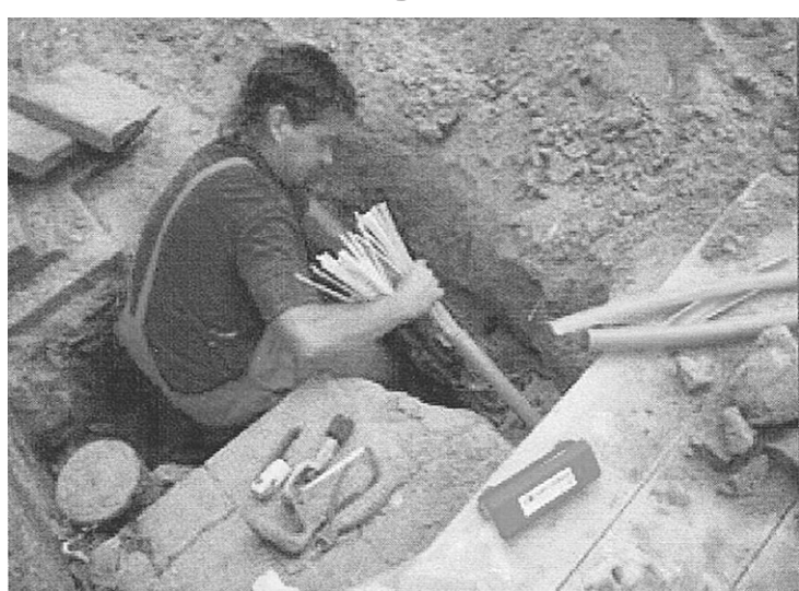
Met de verschillende graafwerkzaamheden zorgt XSM ervoor dat het netwerk tot aan de voordeur komt te liggen.
